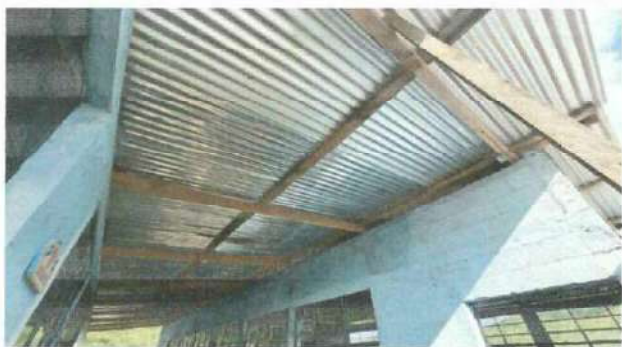
Foto 1: La estructura del techo es inadecuado
