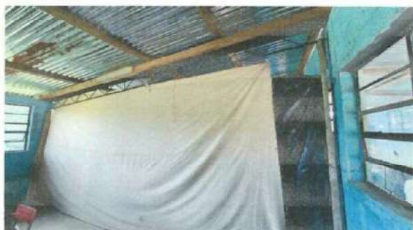
Foto 3: Falta de porton que divide dos aulas
