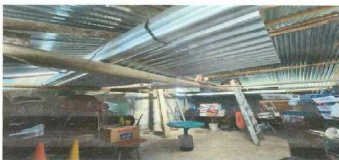
Foto 5: La estructura es Inadecuada
