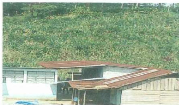
Foto 2: La cubierta se encuentra en mal estado
