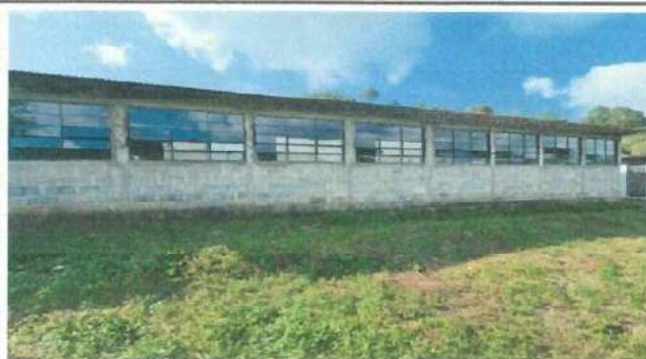
Foto 4: Pareden en deterioro, falta de repello y pintura
